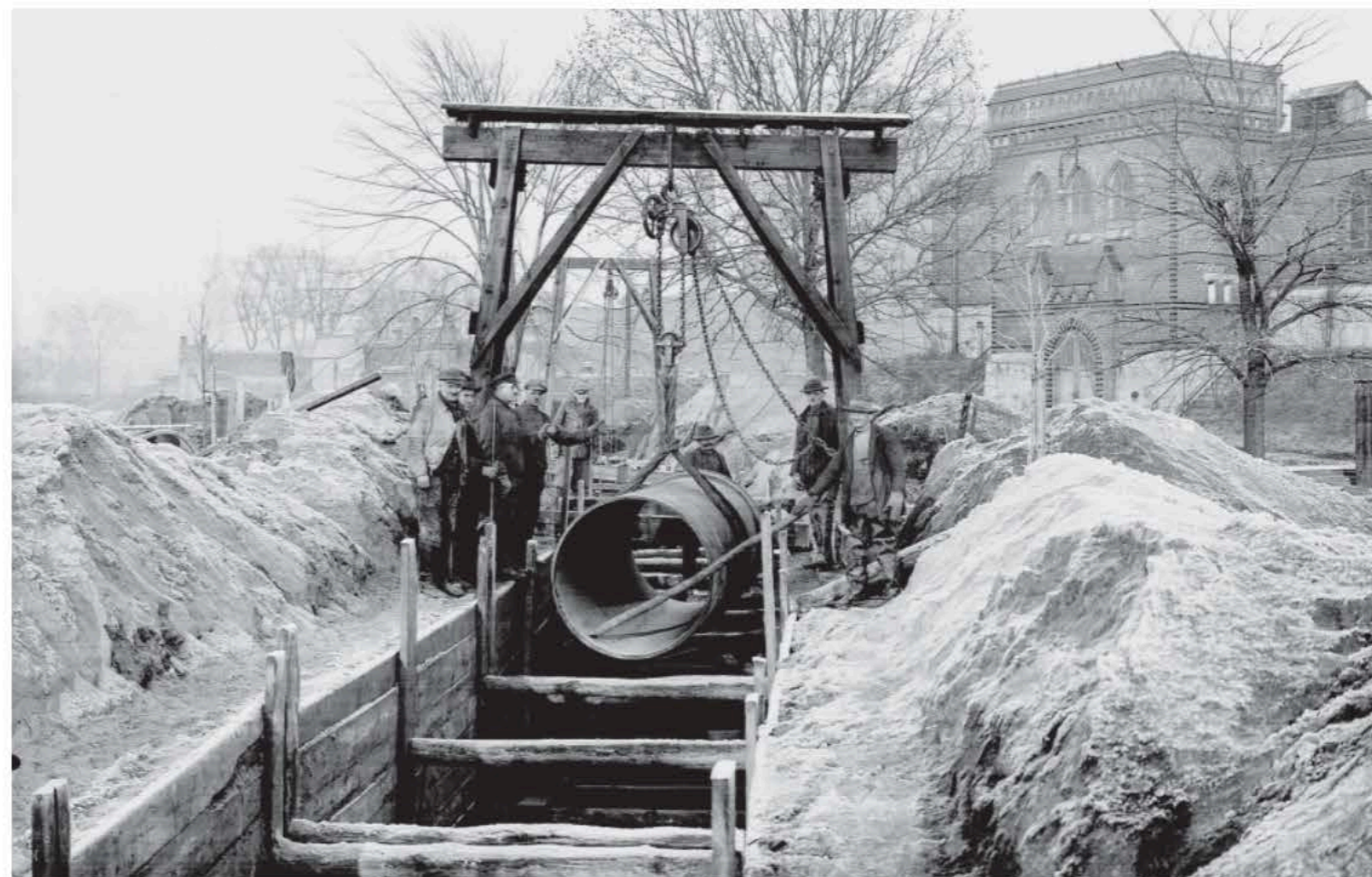
Renowacja rurociągu wody we Wrocławiu, w pobliżu odźwiacza w zakładzie „Na Grobli” – 1936 r. (arch. MPWiK Wrocław)
