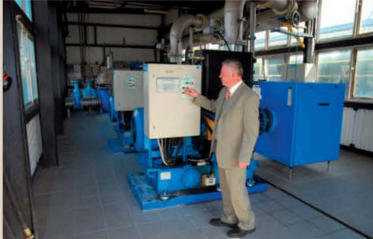
Zakład Oczyszczania Ścieków – Andrzej Kiela kontroluje ustawienie dmuchaw
