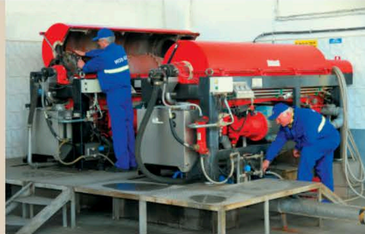
Zakład Oczyszczania Ścieków – Ireneusz Juchimiuk i Ryszard Bechta podczas konserwacji wirówki Noxon
