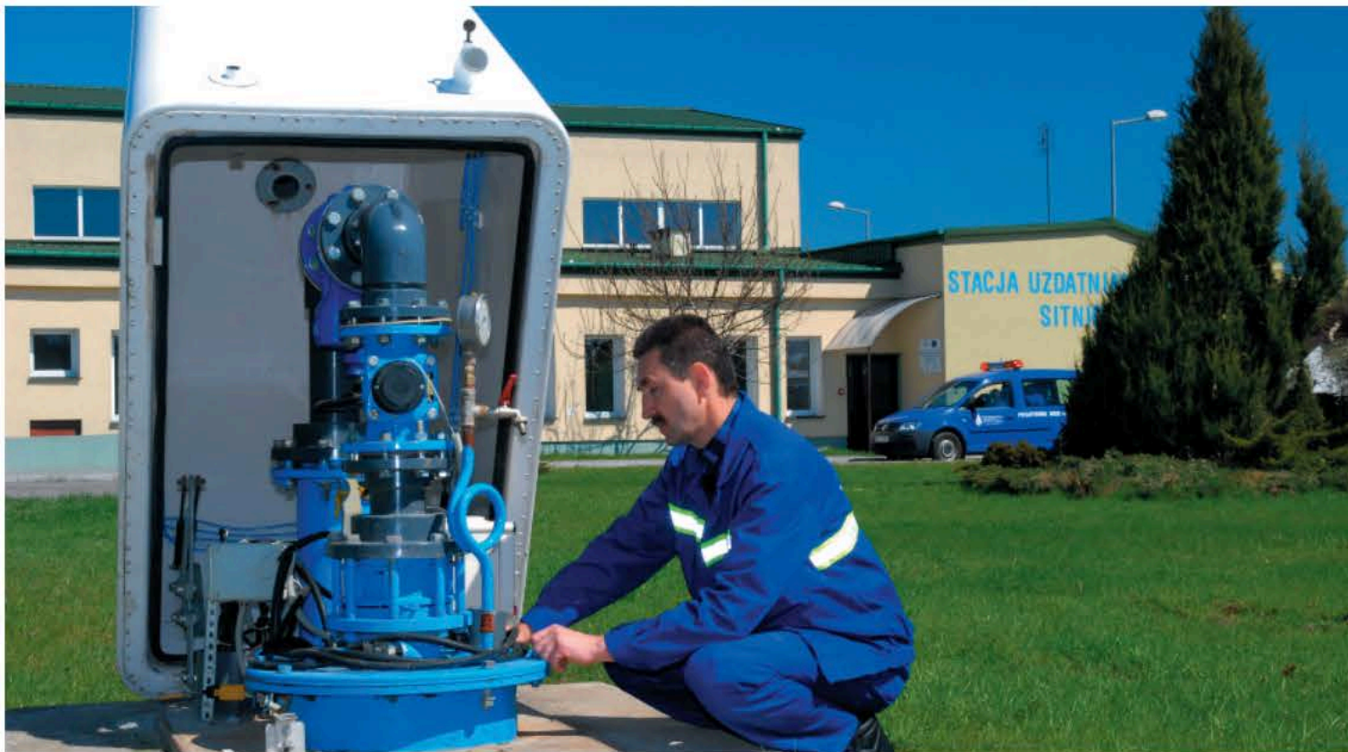
Stacja Uzdatniania Wody Sitnicka – Tadeusz Lecyk przy studni nr 1A
