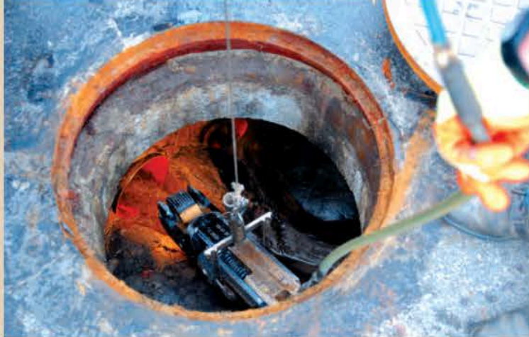
Urządzenie do monitorowania stanu sieci kanalizacyjnej
