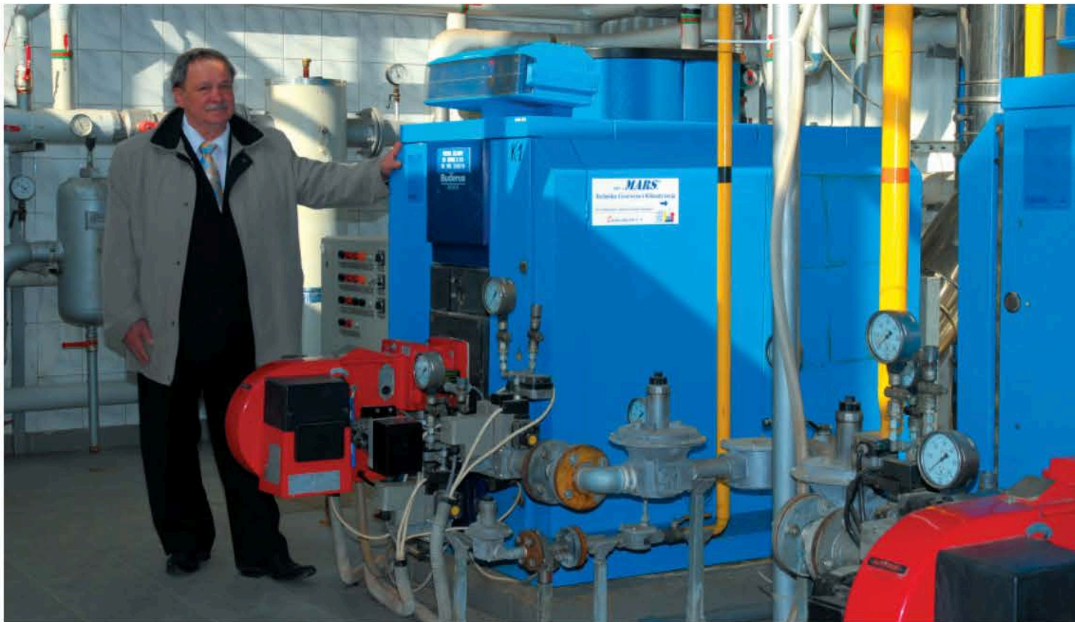
Zakład Oczyszczania Ścieków – inż. Zygmunt Jarosz przy kontroli kotłów na biogaz
