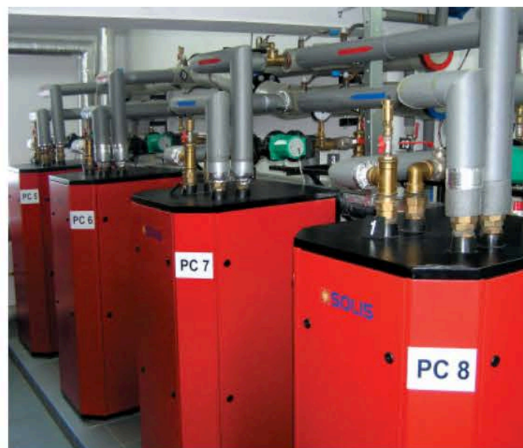
Stacja Uzdatniania Wody Narutowicza – nowoczesne i ekologiczne pompy ciepła
