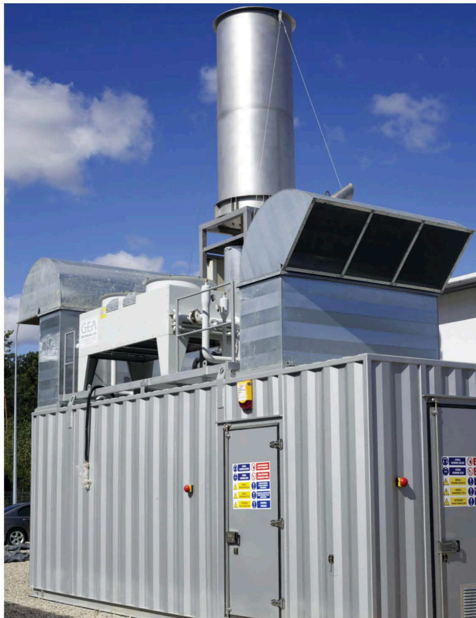
Gazogenerator z pochodnią, wrzesień 2013 r.
