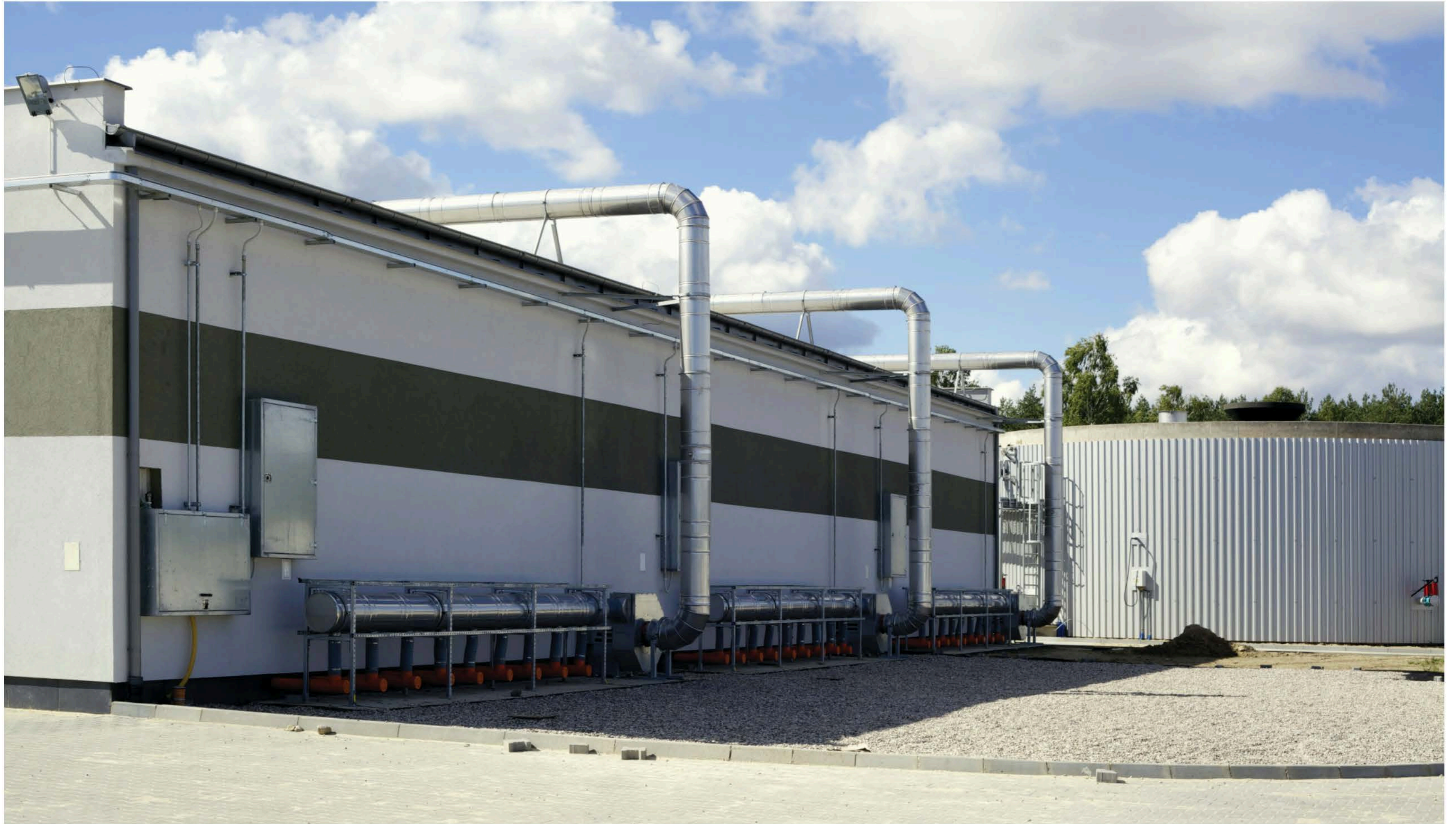
Komory doświeżania z instalacją ujmowania odorów, wrzesień 2013 r.
