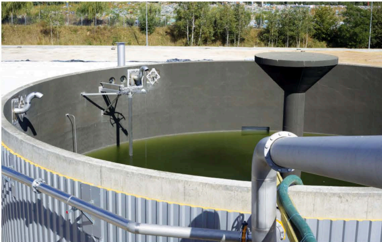
Zbiornik biogazu i odcieku, wrzesień 2013 r.
