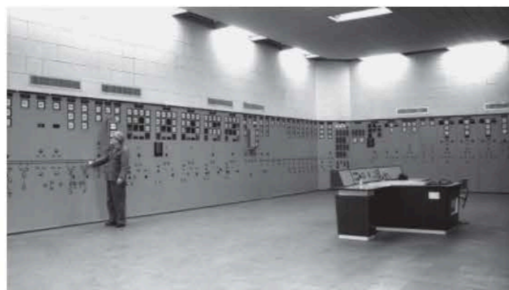
Nastawnia rozdzielni 60 kV i 110 kV – lata 70. XX w. / 60 kV and 110 kV substations control room – 1970s
