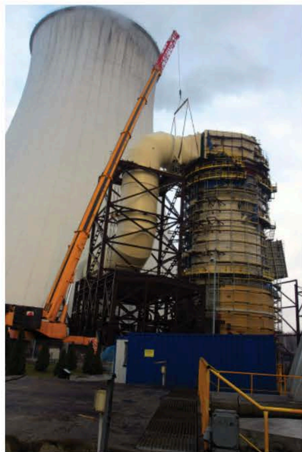
Budowa kanału spalin czystych – element instalacji odsiarczania spalin – 2008 r. / Construction of a clean gas duct – element of the flue gas desulphurisation plant – 2008
