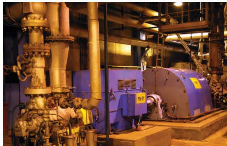
Zespół pomp wody zasilającej – bloki 125 MW / Assembly of feed water pumps – 125 MW units
