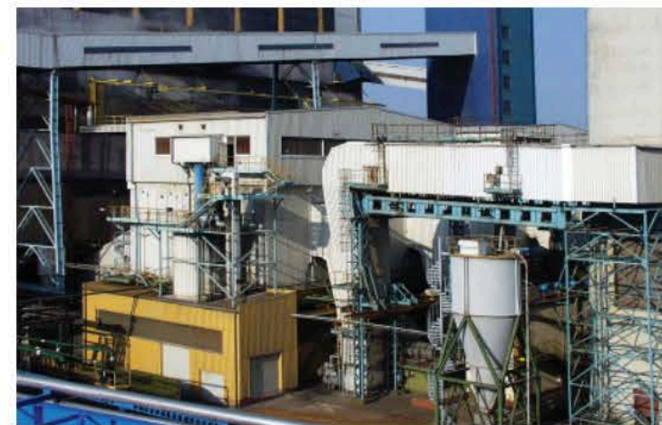
Instalacja odsiarczania spalin bloków 125 MW / Flue gas desulphurisation plant in 125 MW units
