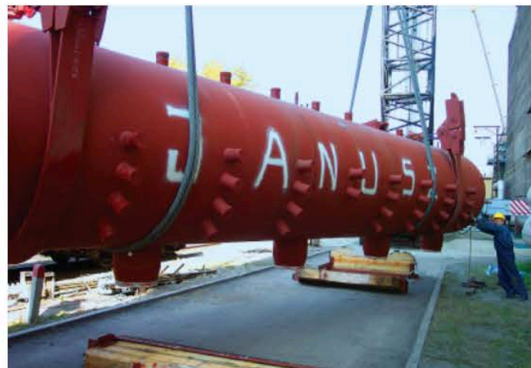
Montaż walczaka kotła OP-380 nr 13 – 2005 r. / Installation of the drum of OP-380 boiler No. 13 – 2005
