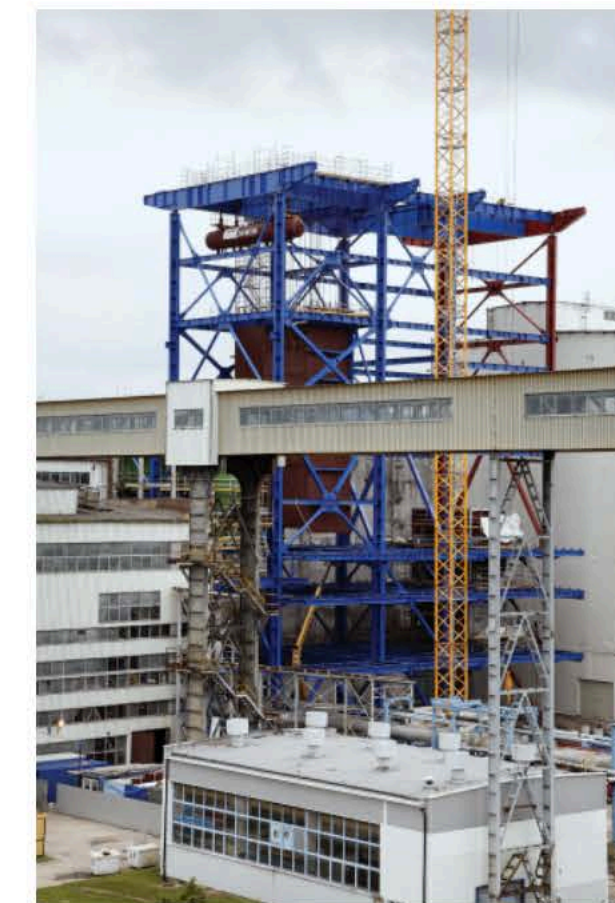
Elektrownia Jaworzno II – budowa kotła biomasowego – 2011 r. / Jaworzno II Power Plant – construction of a biomass boiler – 2011
