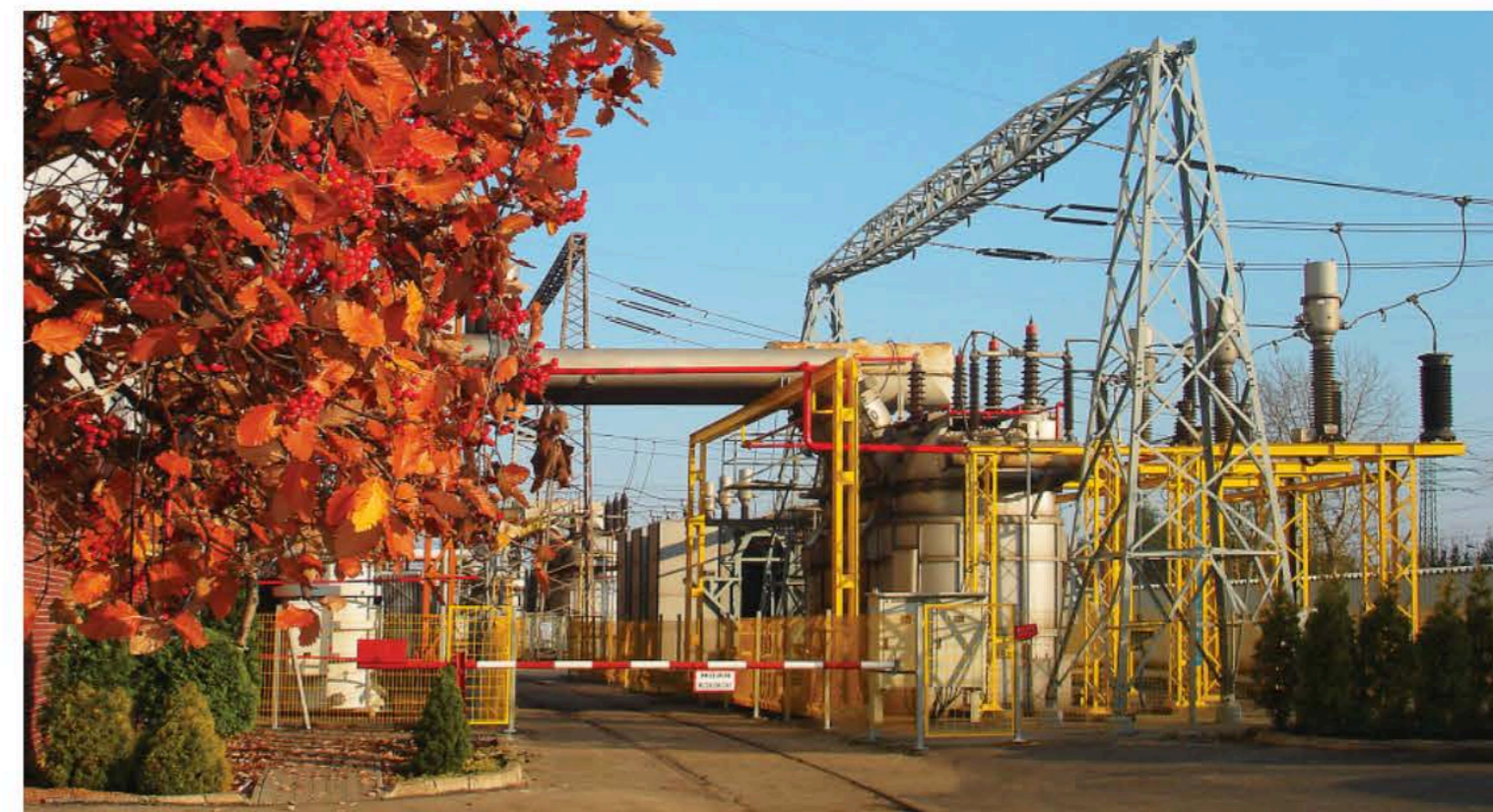
Wyprowadzenie mocy z bloków 225/230 MW / 225/230 MW power units take-off point
