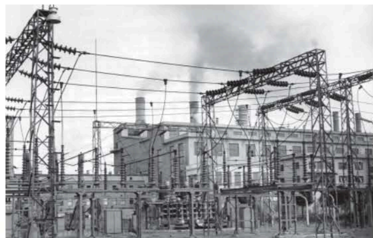
Rozdzielnia wysokiego napięcia i elektrownia – widok z 1965 r. / High voltage substation and power plant – 1965
