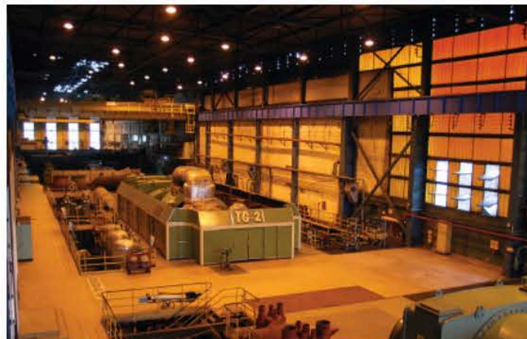
Hala maszyn 125 MW – widok turbozespołu bloku nr 2 / 125 MW engine house – view of turbine set in unit No. 2
