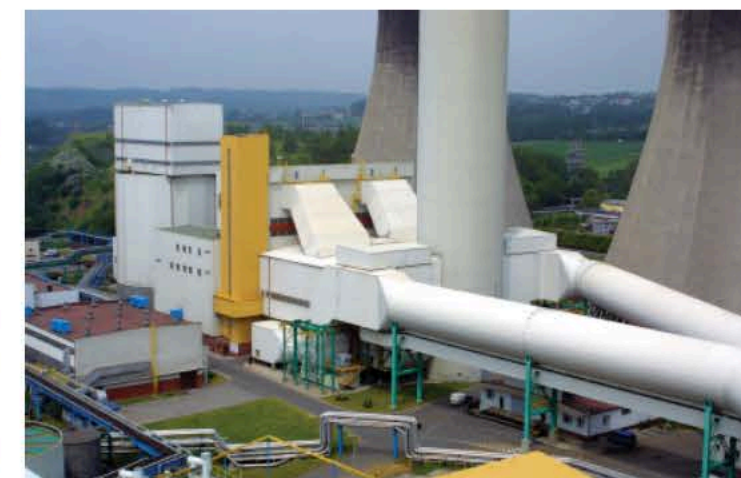
Instalacja odsiarczania spalin wybudowana w latach 1997-2000 / Flue gas desulphurisation plant built between 1997 and 2000
