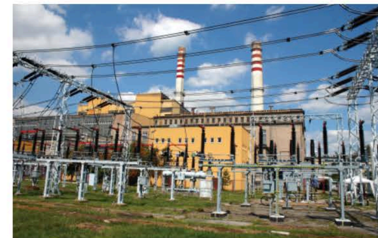
Rozdzielnia 220 kV, w tle część produkcyjna elektrowni – 2008 r. / 220 kV switching station, power generation facilities in the background – 2008
